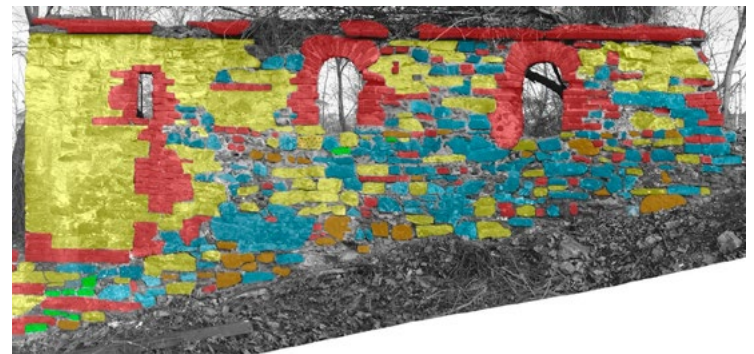
Dochovaný úsek opevnění mezi Neklanovou ulicí a železniční tratí s petrografickým průřezem zdiva: žlutá – opuka, modrá – křemence, hnědá – drobné břidlice, zelená – pískovce, červená – cihly. Podle J. Růžičkové a J. Zavřela. Foto J. Vidman
