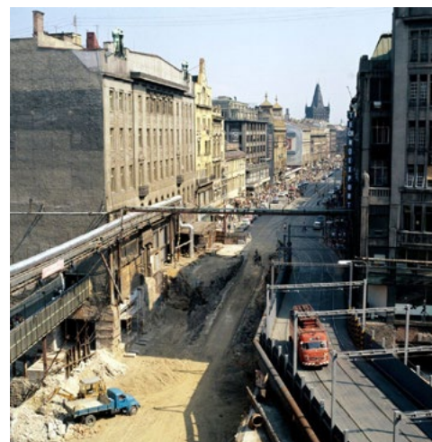
Výstavba stanice metra Můstek v průběhu roku 1976. Pohled do ulice Na Příkopě. Vpravo mostní konstrukce pro tramvaje a vlevo visutá lávka pro pěší podél zbořeného Löbllova domu hedvábní. © Archiv Dopravního podniku hl. m. Prahy, a. s.
